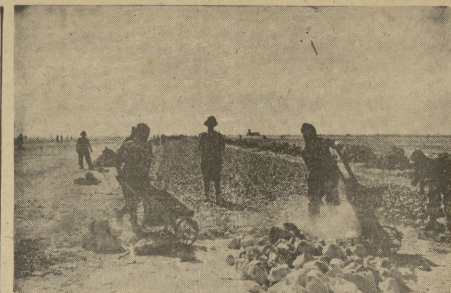
Soldados italianos ocupados en la construcción de carreteras en la región egipcia ocupada, para permitir el avance de los tanques pesados y de las columnas motorizadas.
