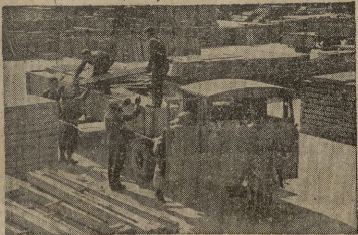
20.000 casas «Ayrey» se están construyendo en Londres, para ayudar a resolver la crisis de la vivienda, conforme a los más modernos planes de construcción en serie. De la fábrica salen millares de bloques de cemento para atender a la ilimitada demanda de casas en todo el país.—(Calpe)
